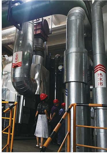
▲检查组对株洲新奥神农城能源服务有限公司直燃机房进行检查 全媒体记者 成姣兰 摄
