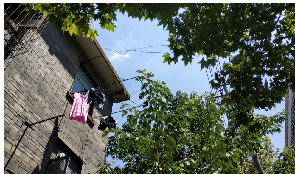
▲居民楼楼顶的铁丝,存在安全隐患也在整治范围内 见习记者 廖智勇 摄
