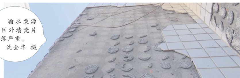
漏水来源 小区外墙瓷片脱落严重。 沈全华 摄
