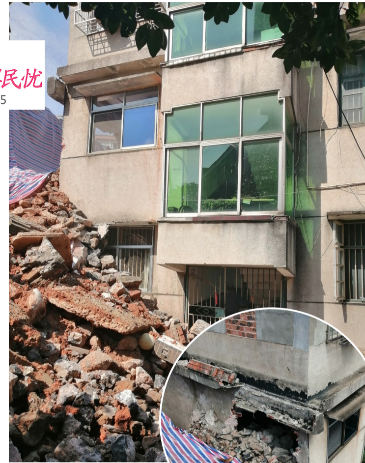
▶护坡垮塌时,二楼墙壁被砸穿 记者 陈驰 摄
