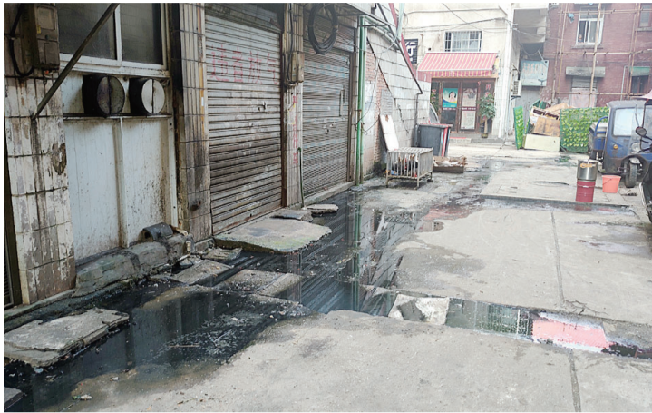
芦淞区洗煤小区,污水漫上地面。沈全华 罗伯钊 摄
