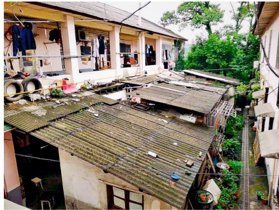
▲曹四村小区部分楼栋房屋面积小,没有配置厕所,部分居民搭建起违章建筑方便生活
