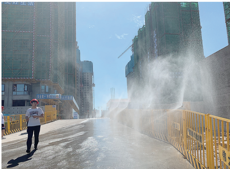
一处楼盘施工现场的扬尘治理喷淋装置 资料图
