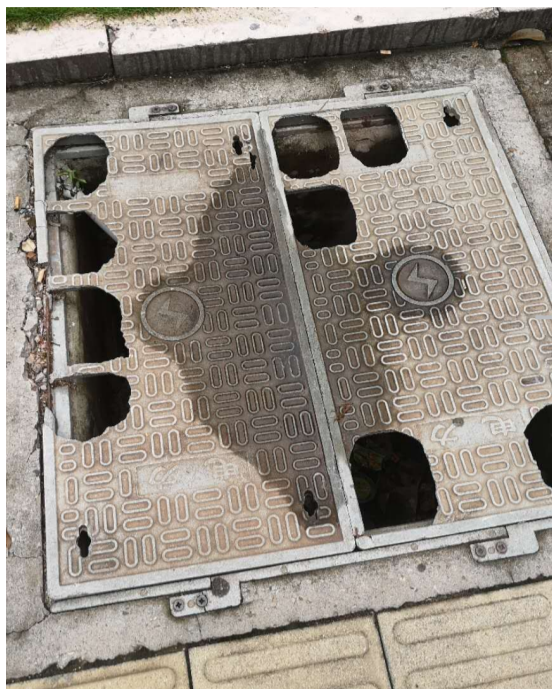
▲人行道上破损的电力井盖 见习记者 陈佳辉 摄
