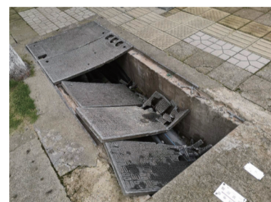
▲人行道上破损的井盖 见习记者 陈佳辉 摄
