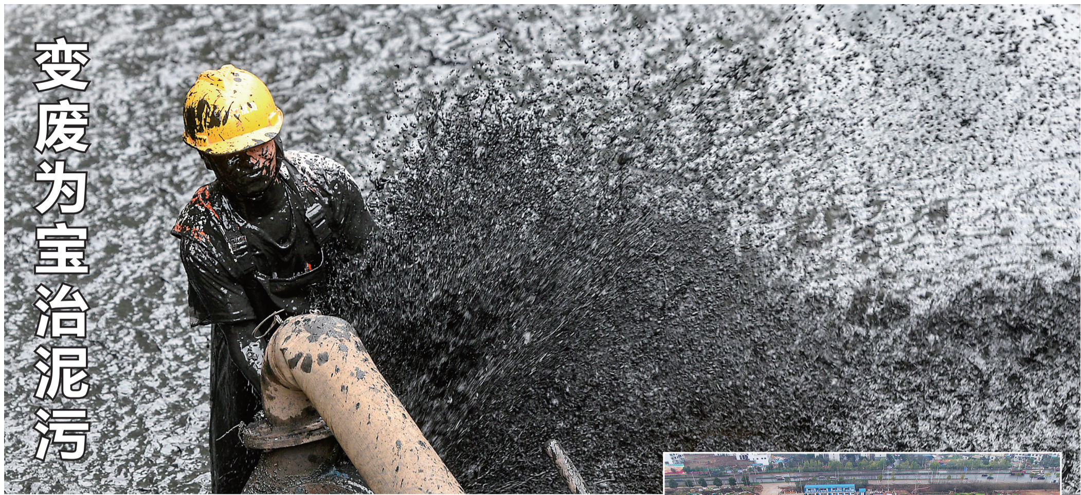
淤泥抽取现场,突发“管涌”,工人顶着泥污奋战。
