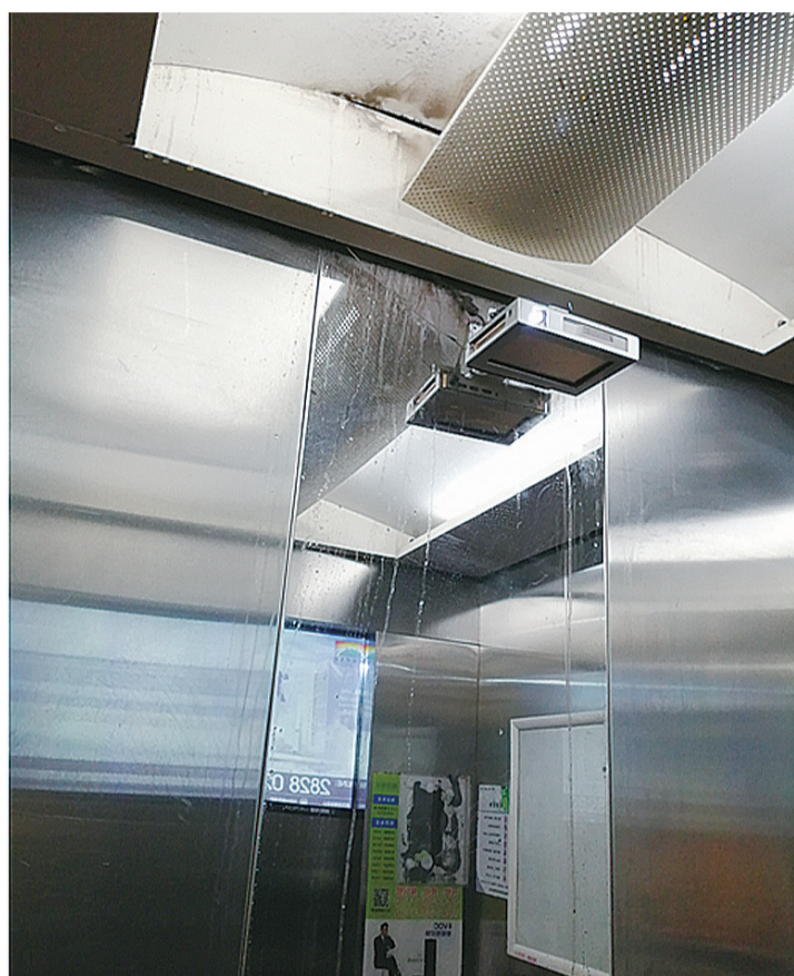
◀电梯间有明显的渗水痕迹 受访者供图
