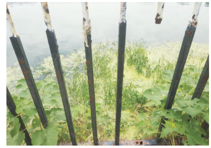
石子湖公园东侧湖边锈断缺失的护栏。周兴海 摄
