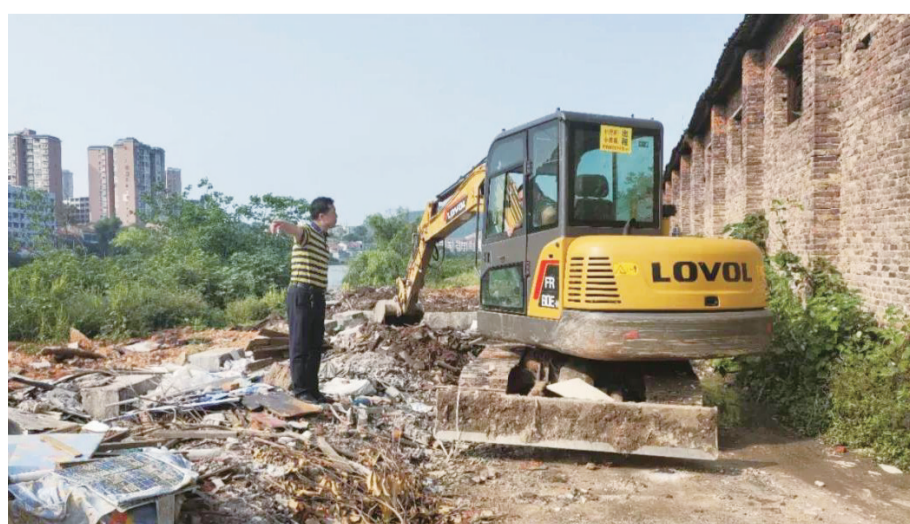
绿水是醴陵人民的母亲河、一级饮用水源地。近日,阳石街河长办、创建办与泉湖村联合对绿水河道河岸进行了巡查,发现绿江大桥旁河岸上堆砌了大量建筑垃圾,迅速安排人员及挖机对现场进行了清理。株洲日报记者 俞强年 通讯员/罗源源 摄
