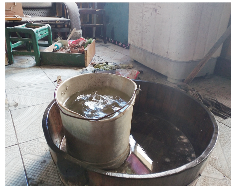
▲大木盆和铁桶叠放接漏水 见习记者 廖智勇 摄
