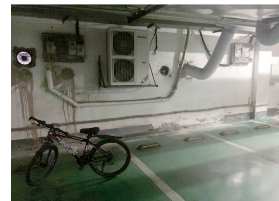
▲地下停车场的墙上有排风扇、排油烟管道 记者 贺天鸿 摄
