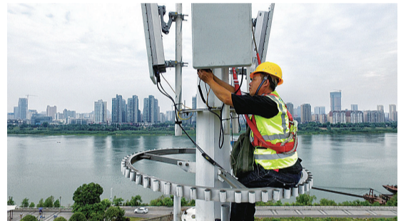
▲5G建设如火如荼,株洲移动工作人员正在贺家土沿江美化塔上安装5G天线
