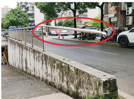
▲天伦路破损的护栏扶手,直突突地对马路 记者 戴凛 摄
