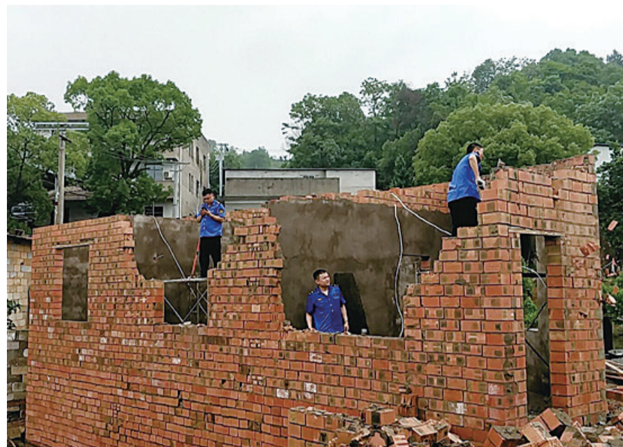
▲本月6日,芦淞城管拆违队员对湘江村2处违建依法拆除 城管部门供图
