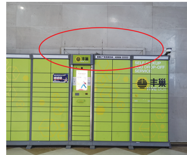
▲消防通道侧门,被快递柜完全封住 记者 姚时美 摄
