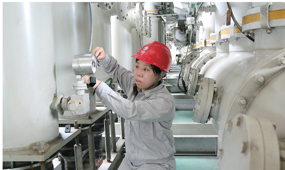
廖丽萍在220千伏叶子冲变电站进行检测工作。受访者供图
