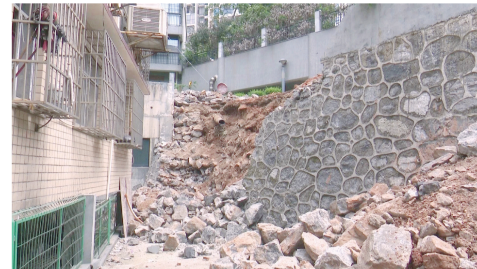
▲小区护坡被挖开,许多石块落在路边 记者 陈驰 摄
