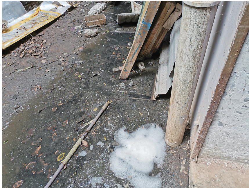
▲农贸市场的下水道堵塞,污水溢到路面 记者 姚时美 摄
