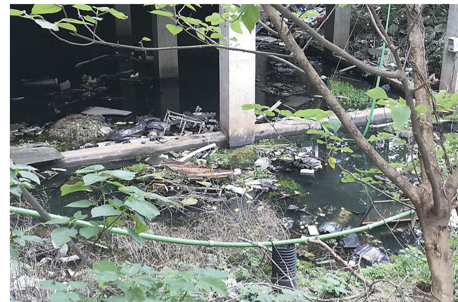
▲26栋地基常年积水 见习记者 黄欣雨 摄
