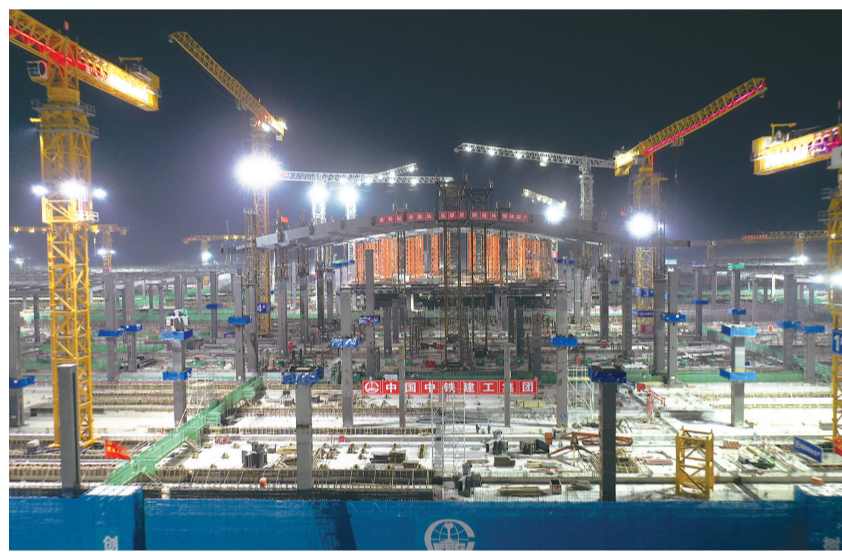
4月26日拍摄的京雄城际铁路雄安站津雄场站施工现场。新华社发 此次提升的钢结构屋盖总长90米,由8块大跨度拱形箱梁拼装组成,最大跨度78米,总重量近3000吨。由于造型特殊,拼装精度、提升精度等施工难度很高。为保证安装精度,钢构件在工厂分
