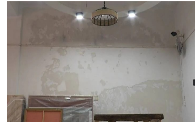
▲门面内墙面渗水颇为严重 受访者供图
