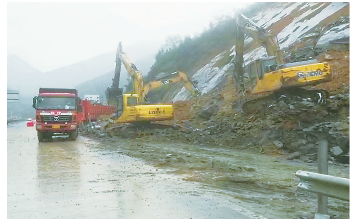
▲4月11日,滑坡路段在进行抢修 通讯员 何华 摄
