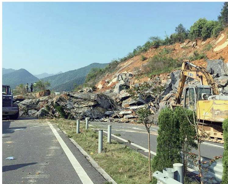
武深高速炎陵段塌方现场。通讯员/吴功诚 摄
