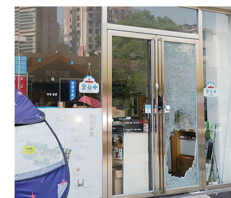
▲ 店铺大门玻璃下方被砸出一个大窟窿 记者 戴凇 摄
