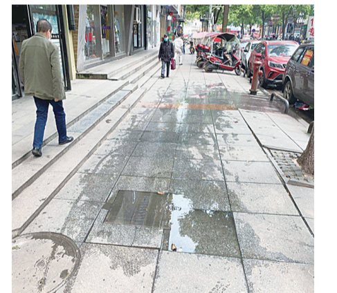
▲田东路下水管道爆裂,现场污水横流 记者 贺天鸿 摄
