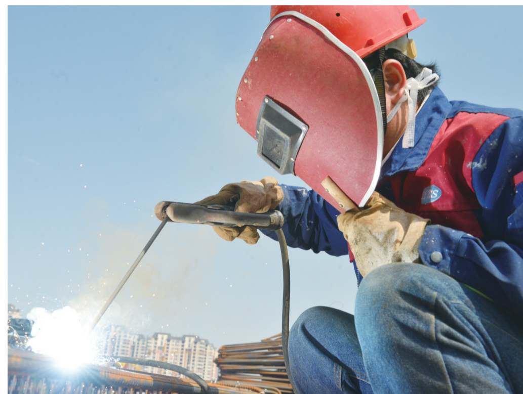
▲洞株路快速化改造工程项目施工现场,焊花四射。该项目全长约13.98公里,双向六车道,预计今年建成使用。
