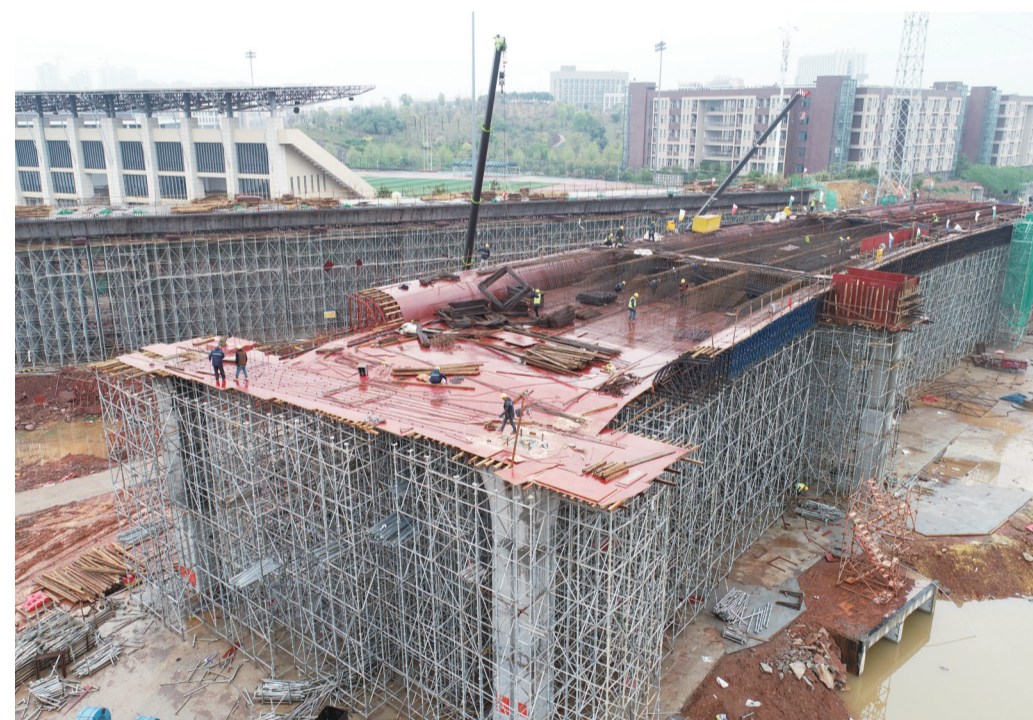
▲北环大道施工现场一片繁忙景象,复工率达到百分之百,项目桥梁桩基础工程完工在即。
