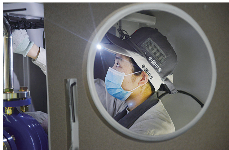
▲钻进柜体为复兴号标准动车组内循环水泵布线的女技术员徐姐
