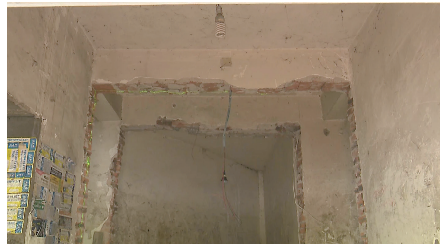
▲一楼承重墙被破坏,导致房屋开裂 记者 陈驰 摄
