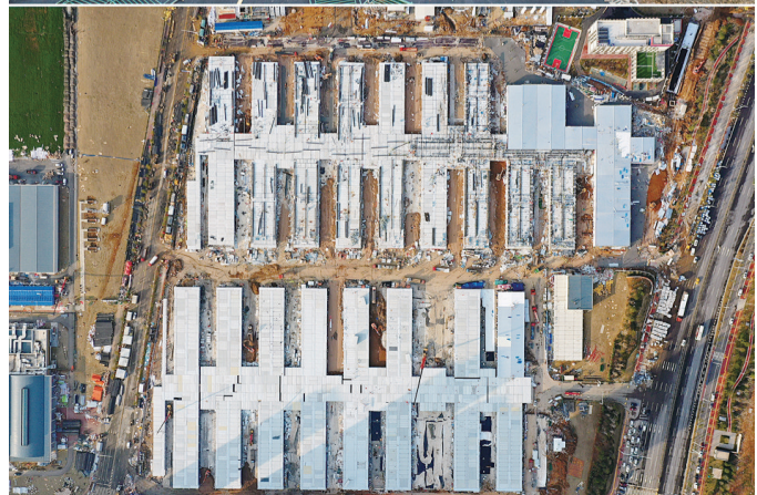
上图是1月26日拍摄的武汉雷神山医院建设工地(无人机照片,新华社记者 肖艺九 摄);下
