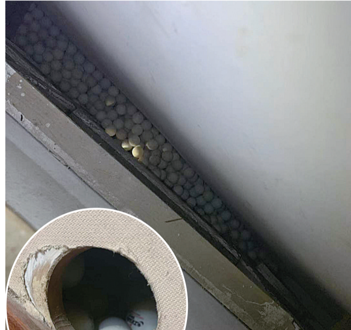
装饰墙和建筑墙体的缝隙中存有大量乒乓球 装饰墙空调管线孔四周有老鼠啃过的痕迹 记者 贺天鸿 摄
