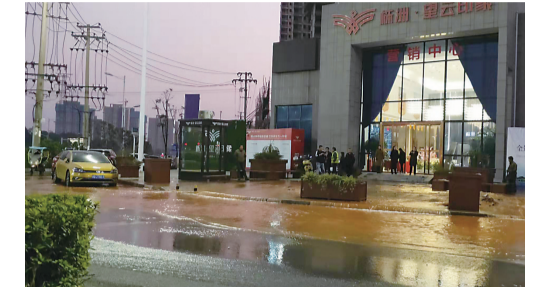
▲昨晚,水管被挖裂后,神农大道附近马路上满是积水 记者 杨凌凌 摄
