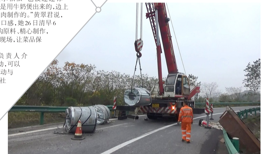
▲钢卷被甩落在高速路匝道,吊车正在起吊 通讯员供图
