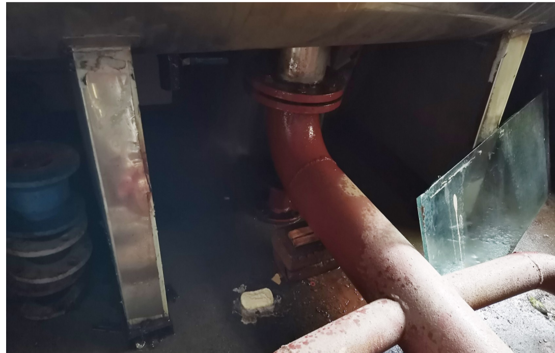
▲储水罐漏水位置 记者 姚时美 摄
