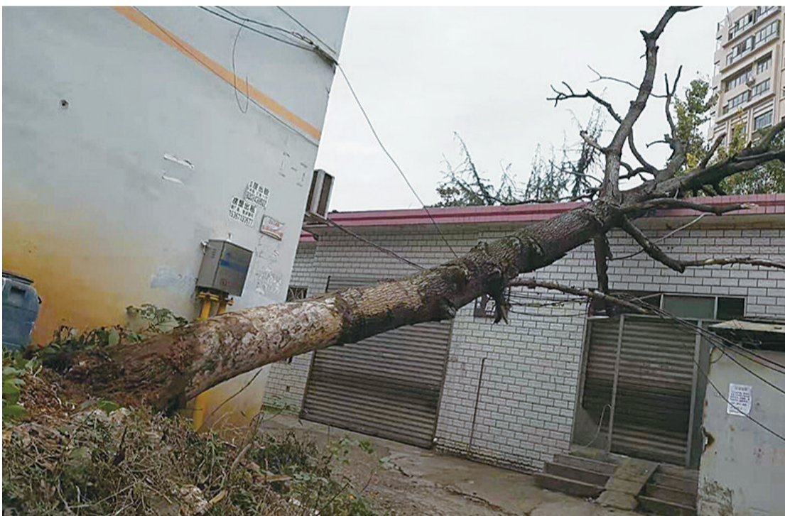
▲荷塘区果木园小区,一棵树木倒伏 通讯员供图
