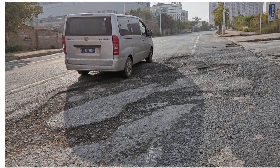
▲创业二路,路面坑坑洼洼 记者 姚时美 摄
