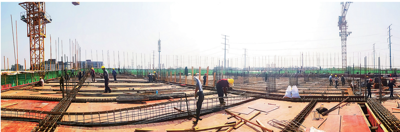
11月5日,湖南数据湖产业园项目一期数据中心楼施工现场,300多位施工工人正在进行梁板钢筋绑扎。项目
