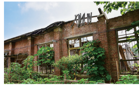
▲干校学员建设的大礼堂屋顶已坍塌 李茂春 摄
