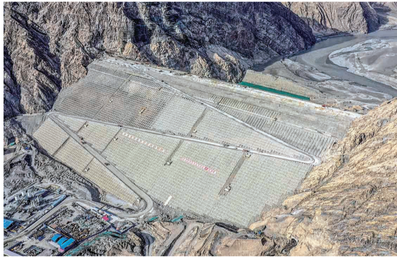
建设中的叶尔羌河阿塔什水利枢纽(8月24日无人机拍摄)。新华社发(李建锋 摄)
