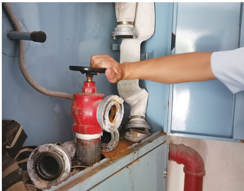
▲天泉一品辉煌世纪小区的消防栓没有水 记者 姚时美 摄
