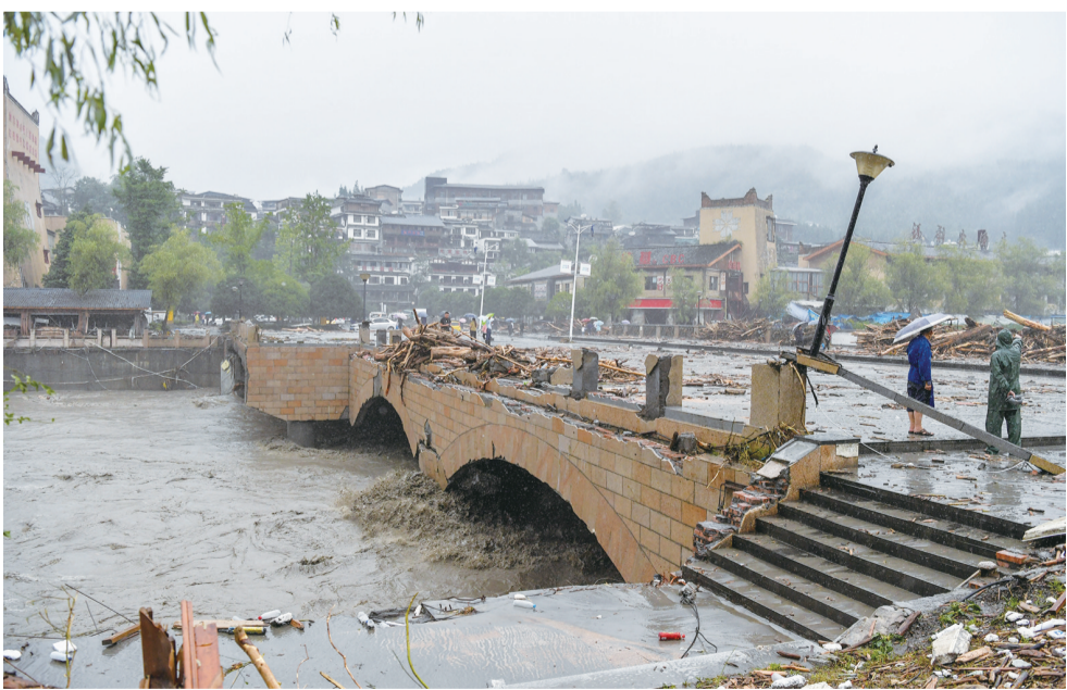
强降雨造成汶川县水磨镇寿溪河上的桥梁受损。新华社记者 张起群 摄
