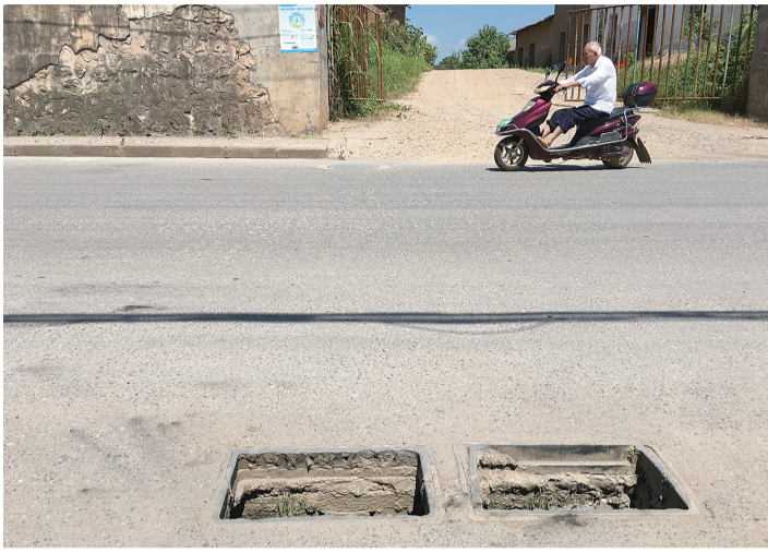
株雷路菜码头候车站前,路面2个井盖缺失。刘平 摄
