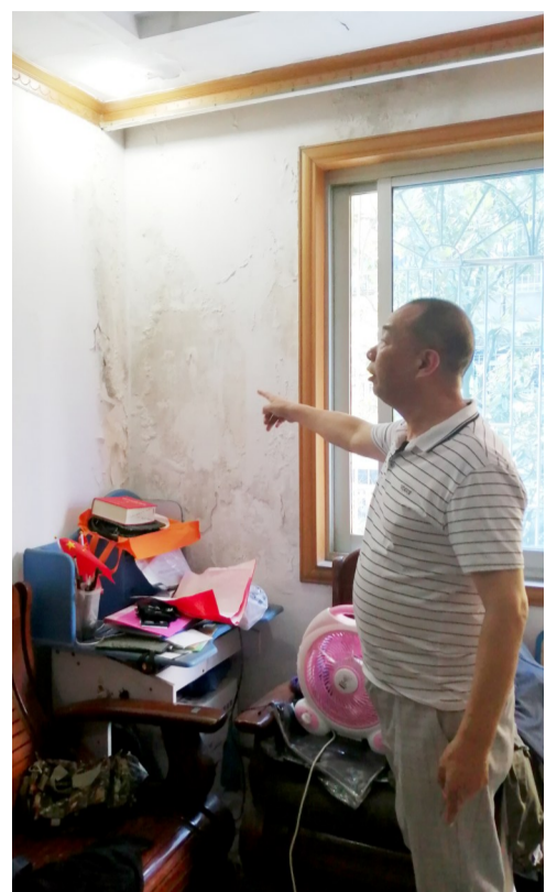
▲墙壁漏水严重,郭先生感到很无奈 记者 陈驰 摄
