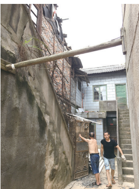
余国建家外墙与邻居家外墙之间用木棍支撑。刘平 摄
