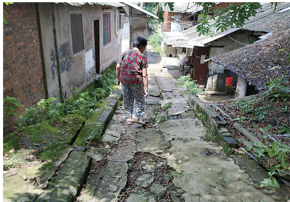
▲上月塘散户区道路坑洼 记者 姚时美 摄
