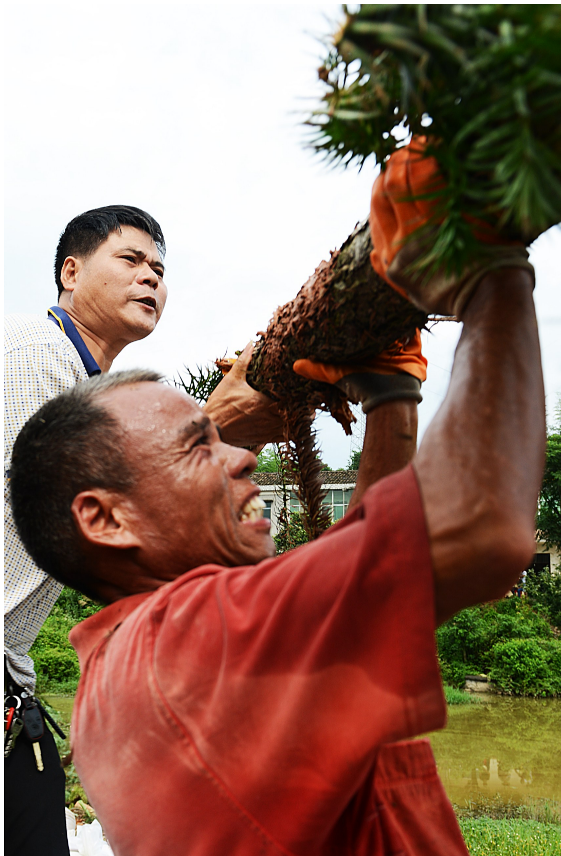
涠口区涠田镇涠田村周家嘴子堤出现开裂下沉,村民和干部跟洪水抢时间,在现场打桩、固基、引流。谭浩瀚 摄
