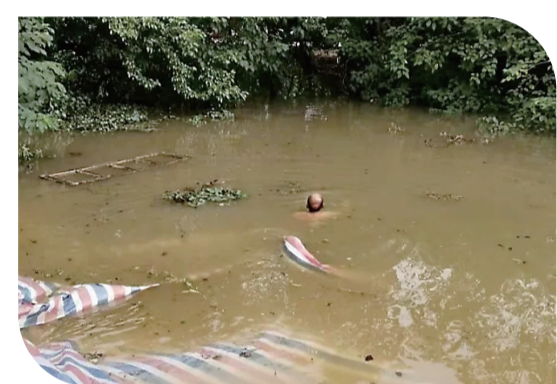
▲11日上午,群丰镇高台岭社区谢家湾组的小组长杨明刚跳进浑水中寻找管涌隐患点 通讯员供图
