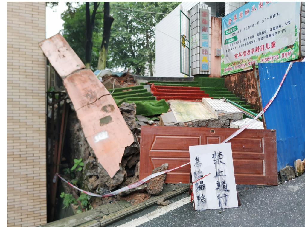
▲幼儿园护坡垮塌现场 记者 姚时美 摄
